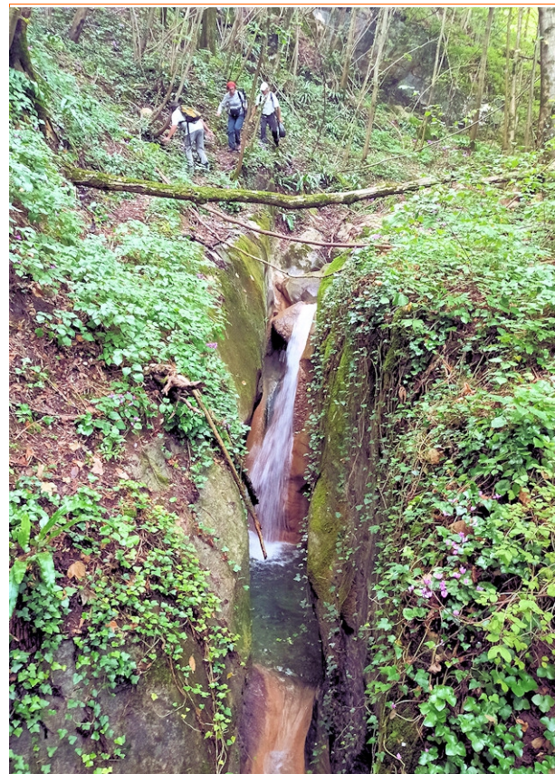
I lavori per la costruzione del nuovo sentiero sulla destra orografica del torrente Lodron.
